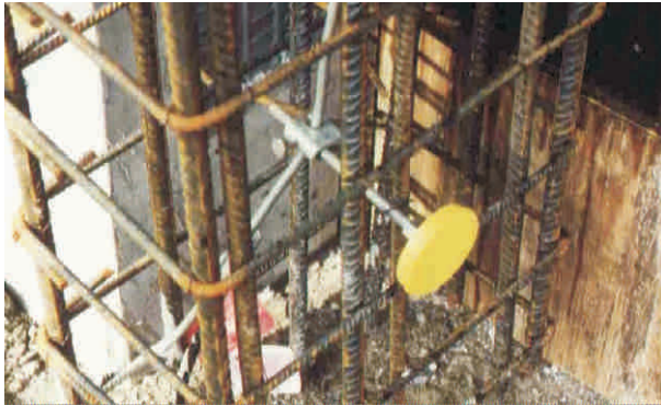
Bild 1: Erdungsfestpunkt in Stahlbetonsäule
