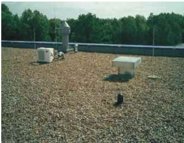
Bild 11: Dachleitungen und Fangeinrichtungen
