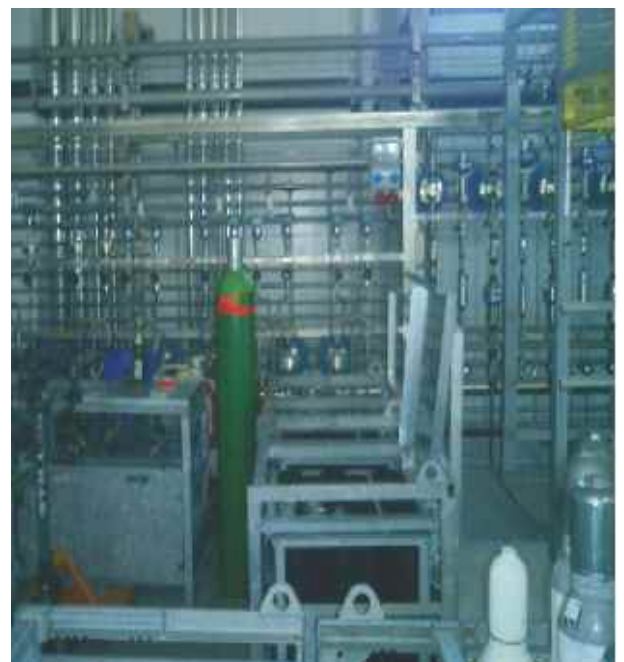
Bild 18: Rohrleitungen im Abfüllbereich
