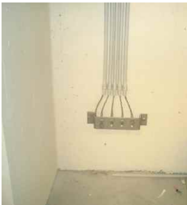
Bild 15: NIRO- Potentialausgleichsschiene mit NIRO- 25 mm 2 -PA-Leitungen
