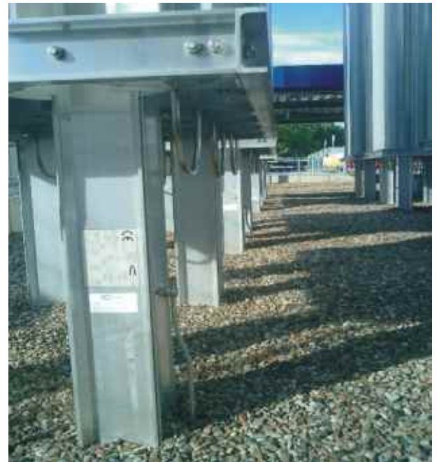
Bild 22: Anschluss eines Umgebungsluft-Verdampfers am Tiefpunkt
