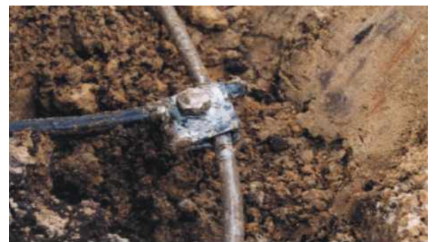
Bild 3: Multiklemmen sind als Verbindungsbauteil im Erdreich nicht geeignet
