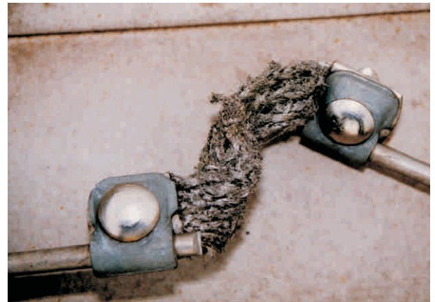
Bild 5: durch Witterungseinflüsse zerfasertes Dehnungsband
